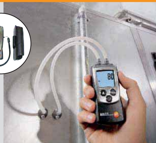
Medición de presión diferencial en filtros
