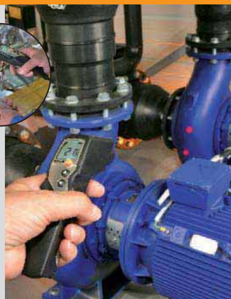
Control de la temperatura de un compresor
