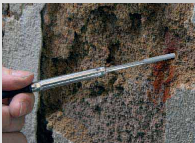
Introducción de la sonda de humedad con cabezal de protección de PTFE en un agujero taladrado
