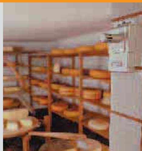
Monitorización de la humedad y la temperatura durante el curado del queso
