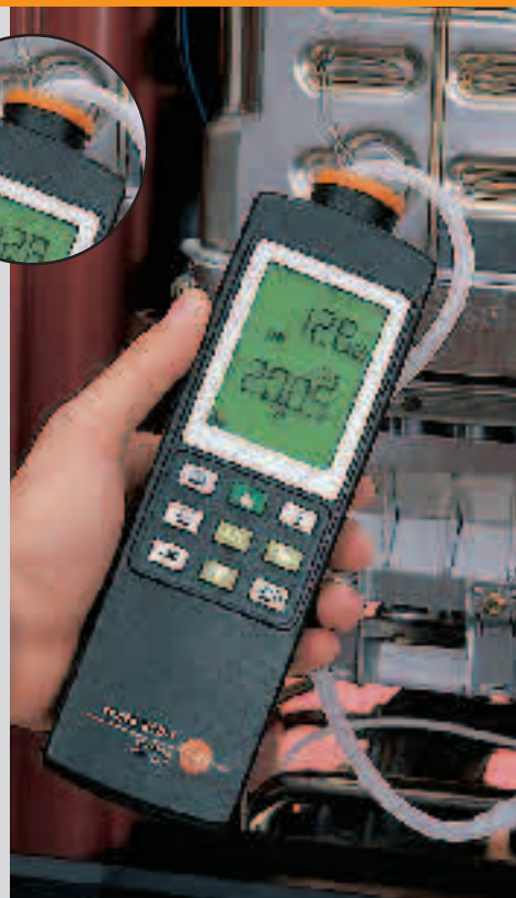
Controlar la presión del caudal de gas
