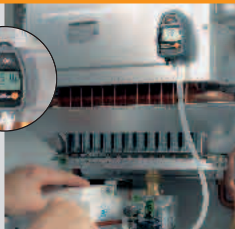
Medición de presión del caudal de gas y tiro
