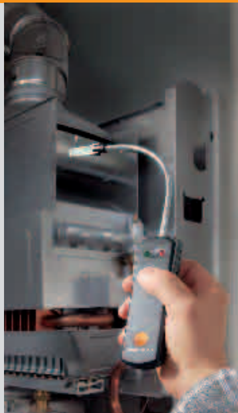
Determina si los gases de combustión se han expulsado completamente de la caldera
