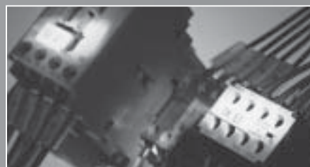
Ident. de contactores y lugares de emplazamiento
