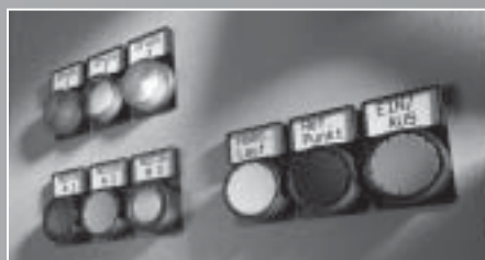
Identificación de pulsadores de equipos de mando
